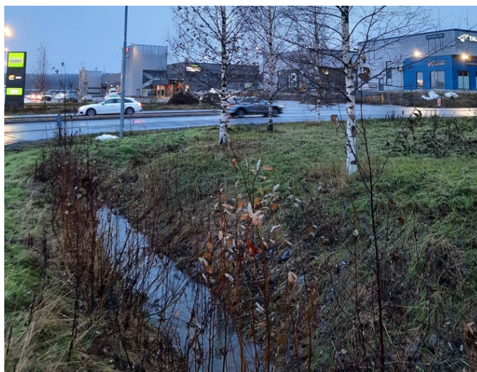
Kuva 5. Penkereeltä avo-ojan hulevedet kulkevat Toivionkadun alittavaan rumpuun. Kuvan avo-oja ja koivuistutukset kuuluvat vireillä olevan asemakaavan rajaukseen.
